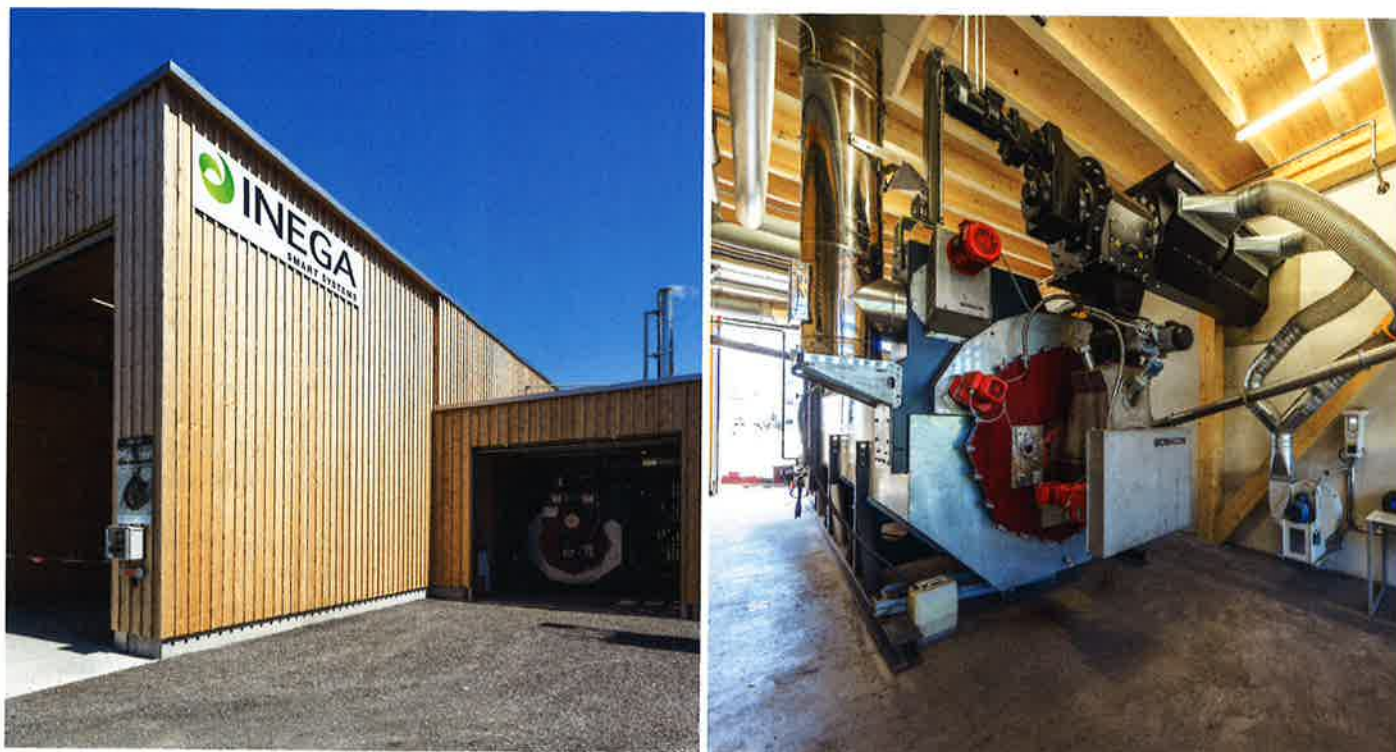
Der Pyrolysereaktor ist in einem funktionellen Gebäude aus einheimischem Fichten- und Tannenholz untergebracht. Die Anlage verkohlt pro Stunde rund 350 Kilogramm Biomasse. Daraus resultieren rund 65 Kilogramm Pflanzenkohle.
